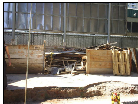
Figura 6 – Baia de madeira no térreo
