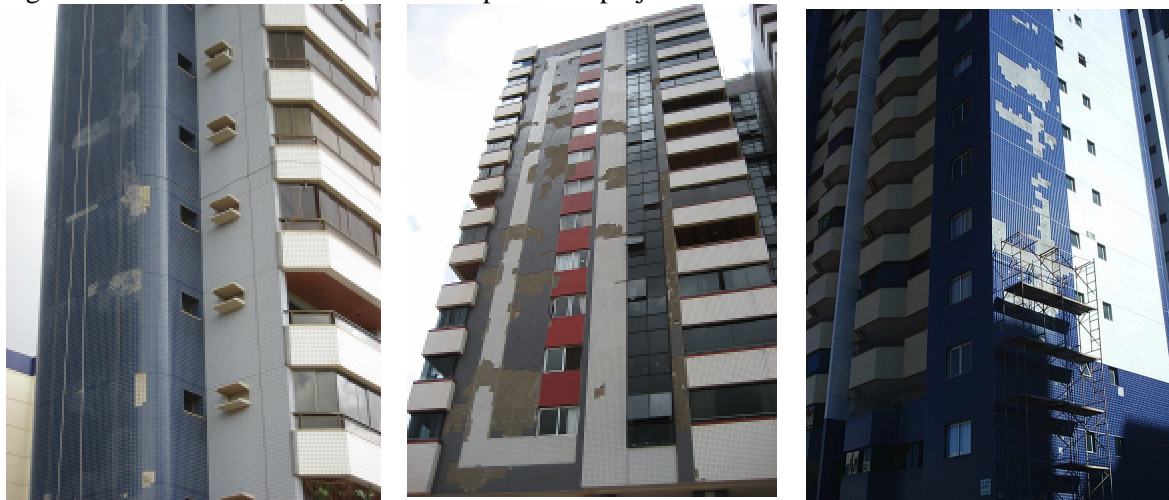
Figura 2 – Descolamento do revestimento cerâmico em fachadas de edifícios em Águas Claras.
