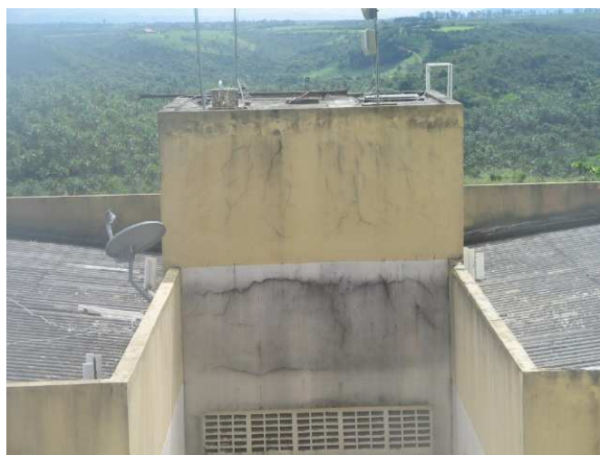
Figura 01: fissuras horizontais no topo da fachada da edificação
