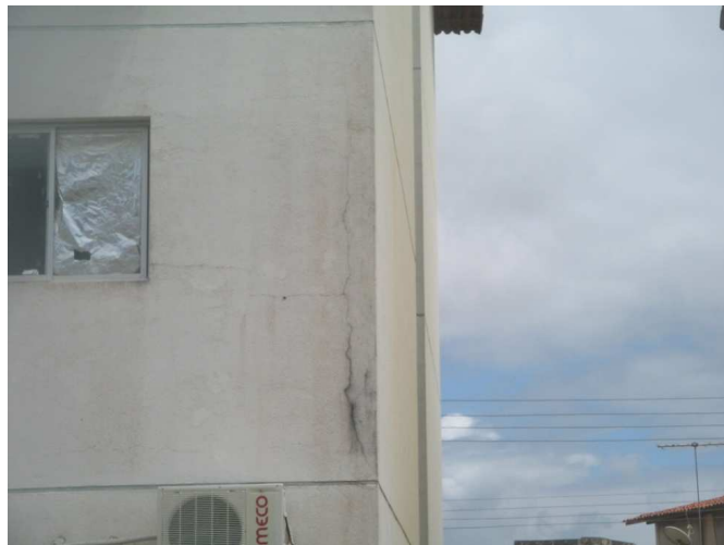
Figura 03: fissura vertical no canto da fachada
