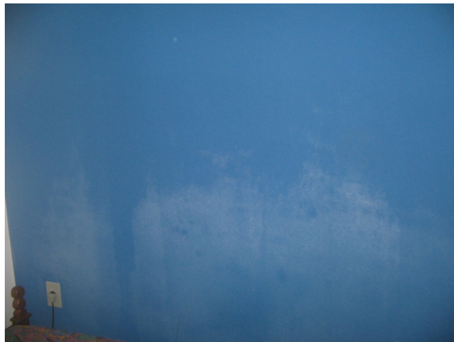
Figura 05: manchas na pintura da parede causadas pela umidade
