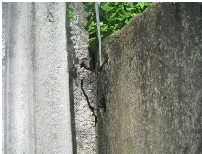
Figura 04: Divisa do muro externo trincado
