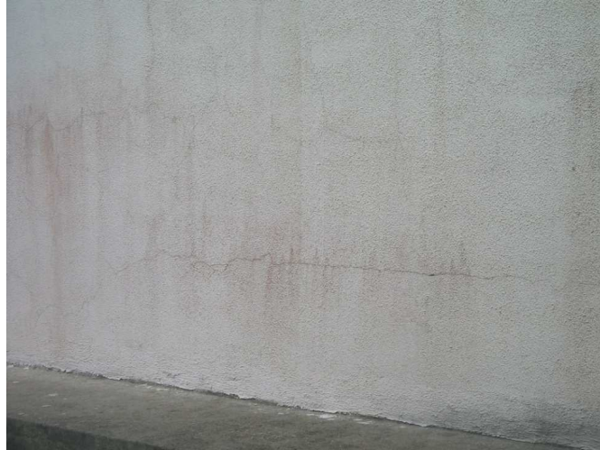
Figura 02: fissuras horizontais e mapeadas no primeiro pavimento
